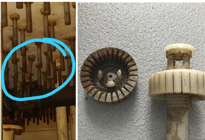
Mangelursache: gebrochene Düsen
